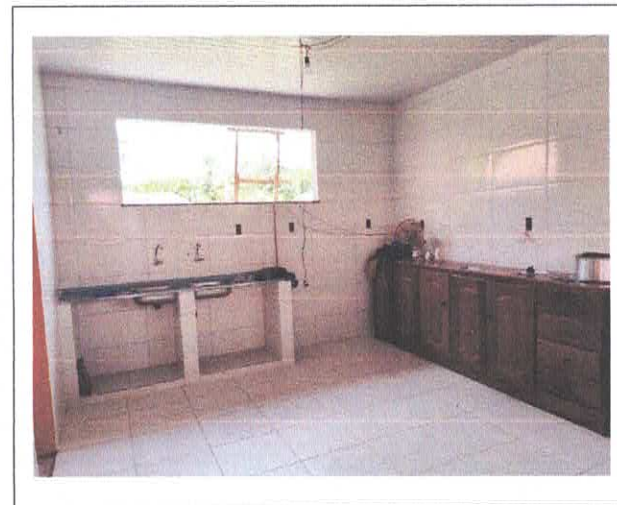
BANCADA E PONTOS HIDROSSANITÁRIOS
