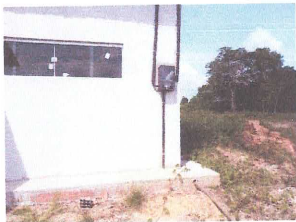
Foto 10-Vista do padrão de energia
