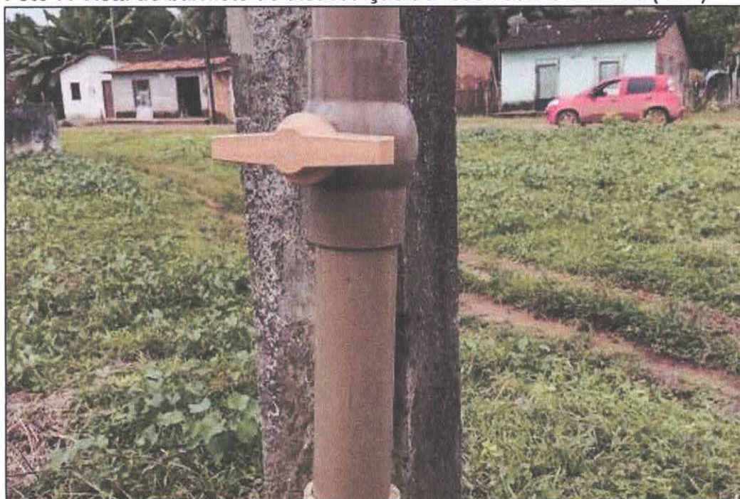
Foto 7: Vista do barrilete de distribuição do reservatório elevado (REL).
