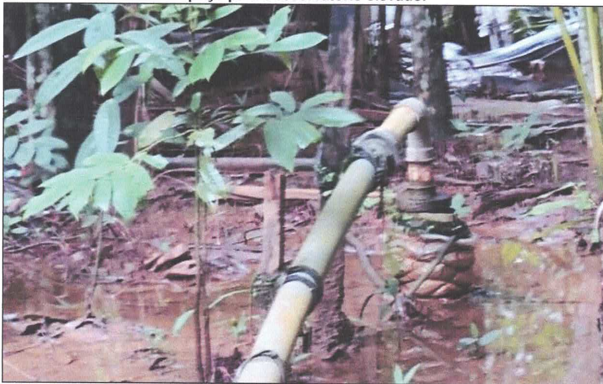
Foto 5: Captação – Poço isolado equipado com bomba submersa, recalcando água direto do poço para o reservatório elevado.
