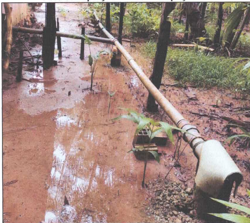
Foto 3: Captação - Bateria de poços
