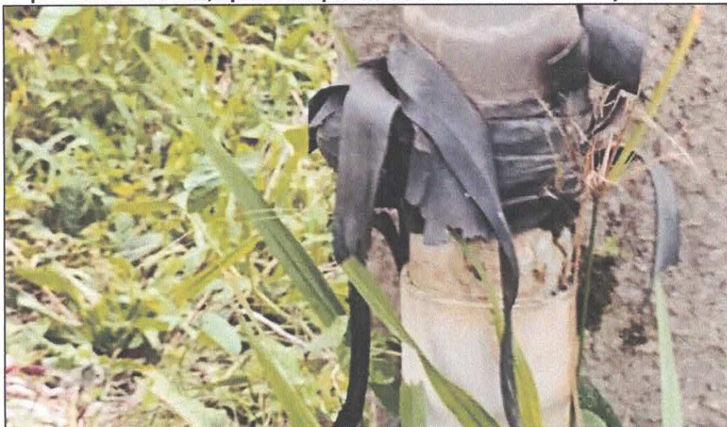
Foto 6: Vista do barrilete de alimentação do reservatório elevado (REL), como podemos verificar, apresenta problemas e consertos inadequados.
